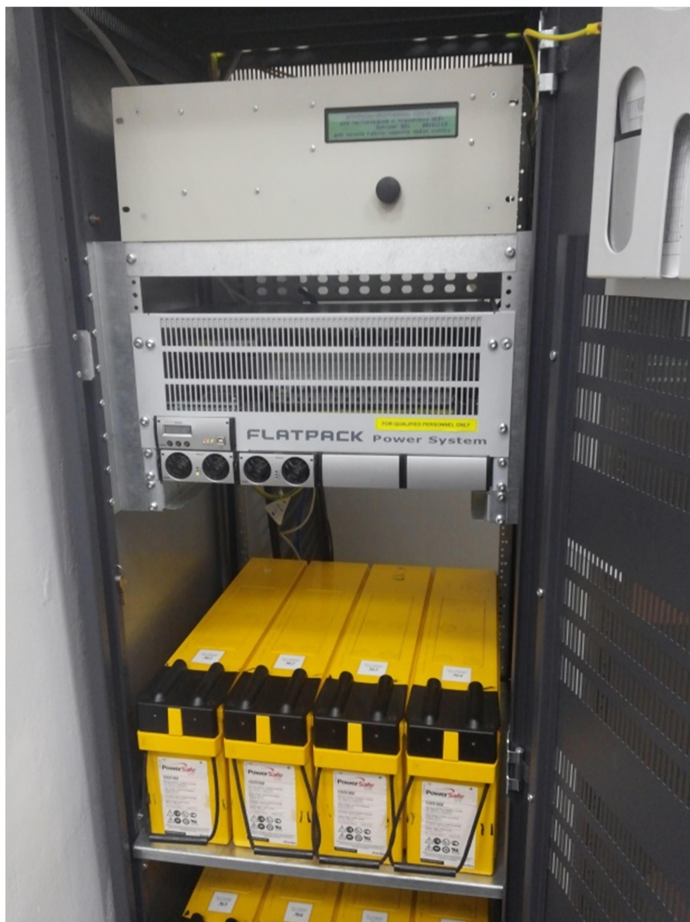
Рисунок 4.12 – Аппаратно-программный комплекс для технического обслуживания, тестирования и тренировки аккумуляторных батарей систем гарантированного электропитания
